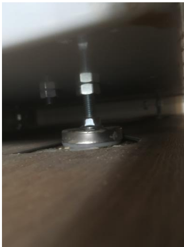
Figuur 3.1 Steunvoetje warmtepomp huidige situatie
