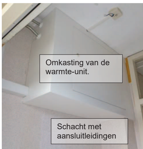
Figuur 6.2 Voorbeeld van opstelling warmte-unit in de hal van een galerijwoning
